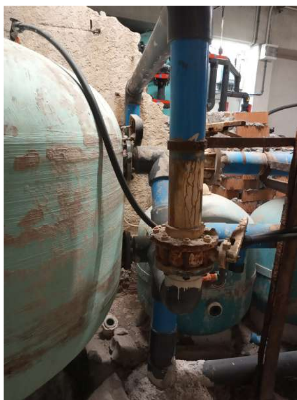
Figura 12. Detall de la maquinària actual del sistema de tractament de la piscina gran
