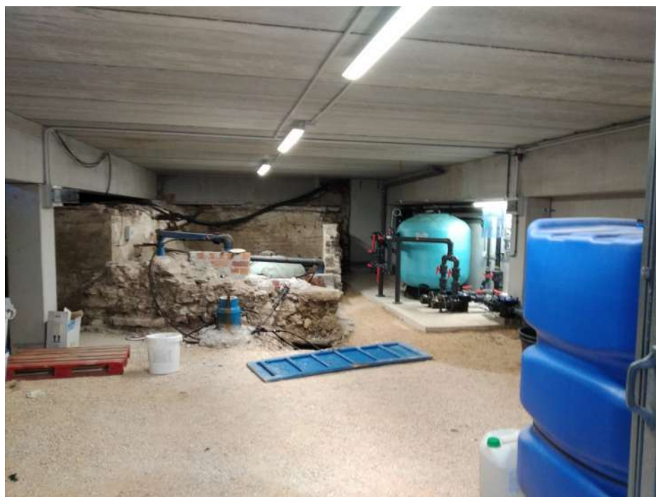
Figura 7. Vista general de la sala de màquines des de l'accés directe pel carrer
