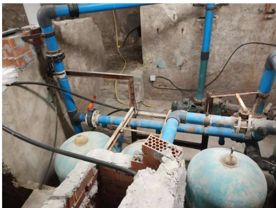
Figura 14. Detall de la maquinària actual del sistema de tractament de la piscina gran
