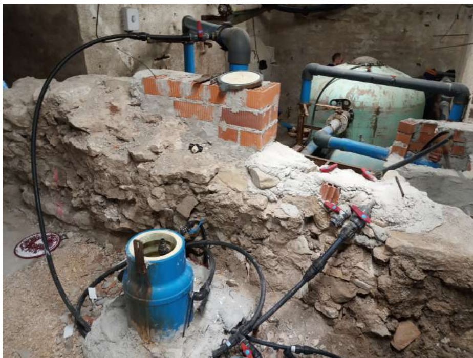
Figura 13. Detall de la maquinària actual del sistema de tractament de la piscina gran
