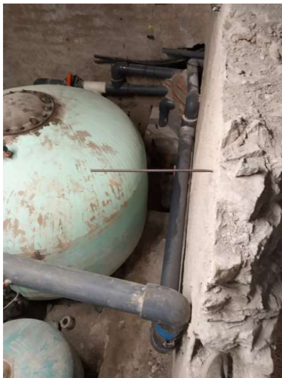
Figura 15. Detall de la maquinària actual del sistema de tractament de la piscina gran
