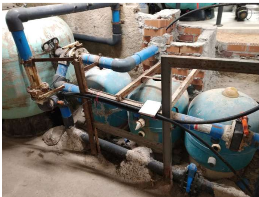
Figura 11. Detall de la maquinària actual del sistema de tractament de la piscina gran
